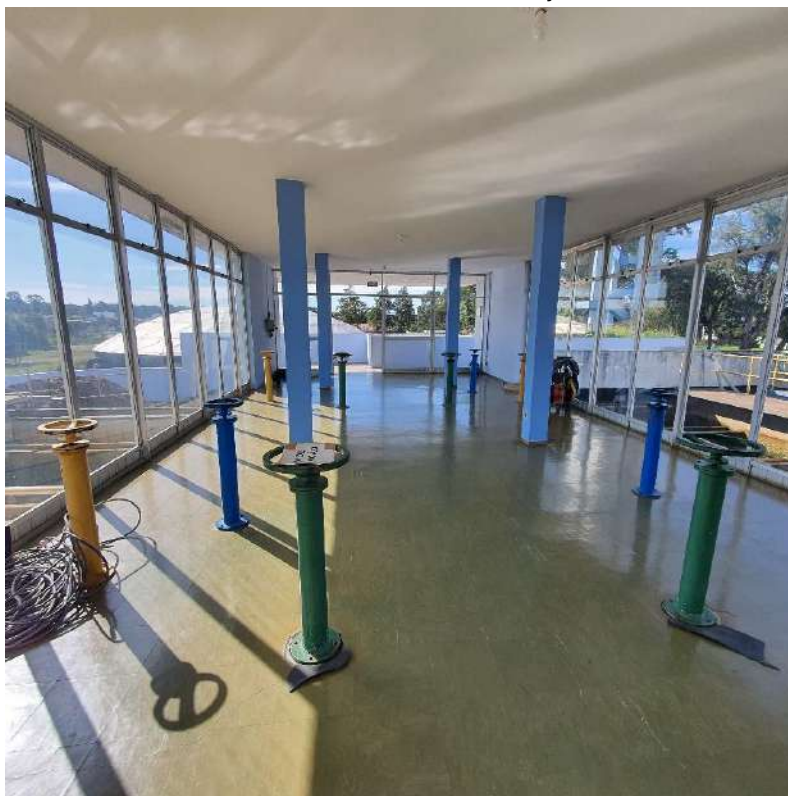
FIGURA 39 – SALA DE CONTROLE E OPERAÇÃO DOS FILTROS
