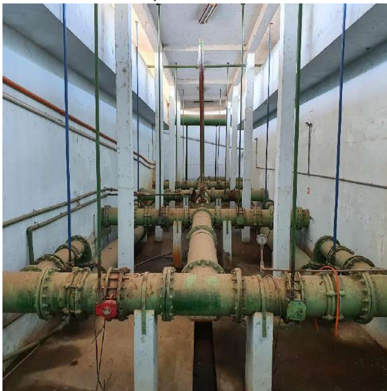
FIGURA 40 – TUBULAÇÃO DE RETROLAVAGEM DOS FILTROS
