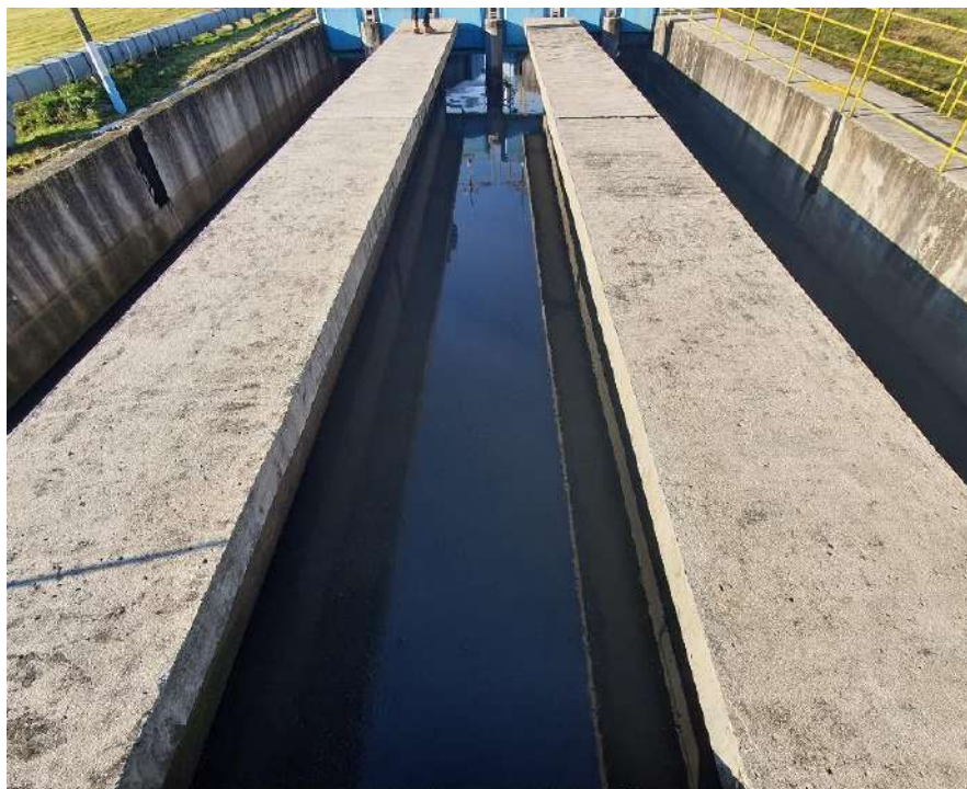
FIGURA 98 – CAIXAS DE AREIA – ETE CENTRAL
