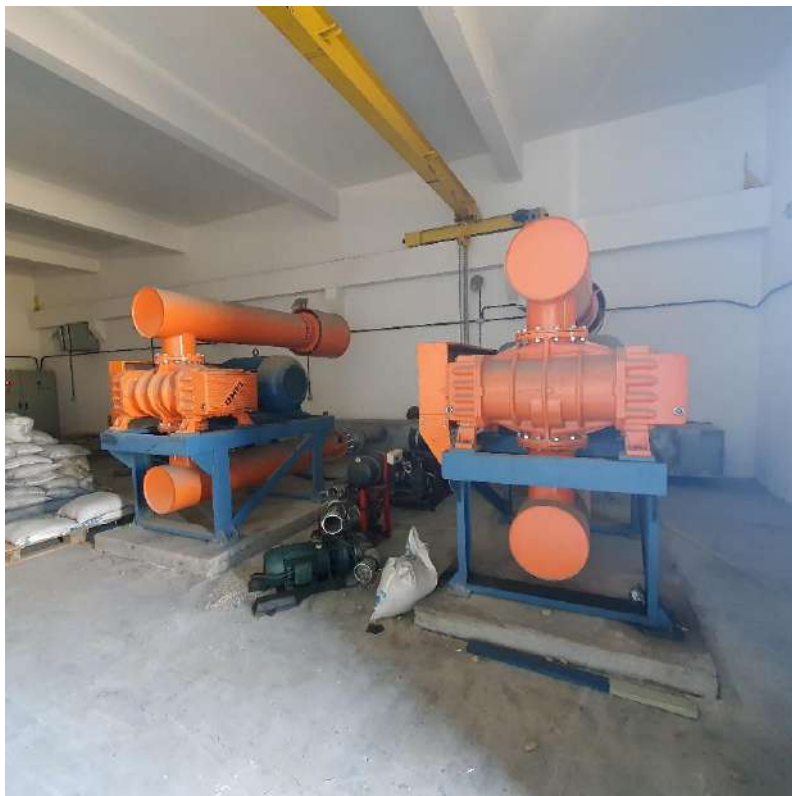
FIGURA 108 – SOPRADORES – ETE CENTRAL
