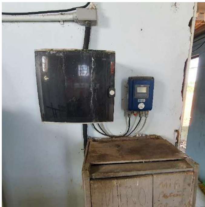
FIGURA 29 – VISOR MACROMEDIDOR – AAB BARRAGEM EMERGENCIAL
