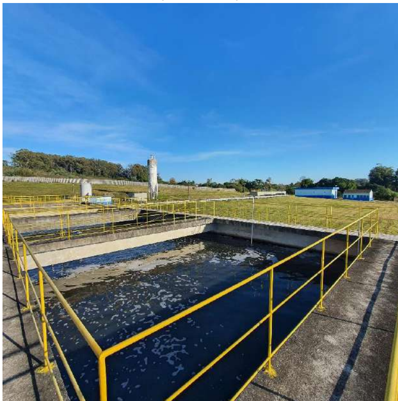
FIGURA 103 –TANQUE DE AERAÇÃO - ETE CENTRAL
