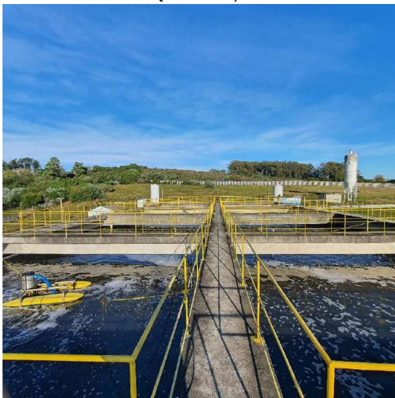
FIGURA 104 –TANQUE DE AERAÇÃO - ETE CENTRAL
