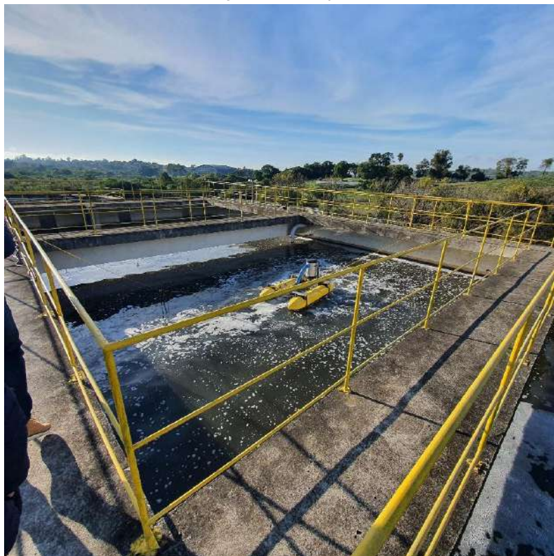
FIGURA 101 –TANQUE DE AERAÇÃO - ETE CENTRAL
