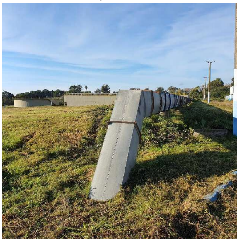
FIGURA 100 – TUBULAÇÃO DO SOPRADOR – ETE CENTRAL
