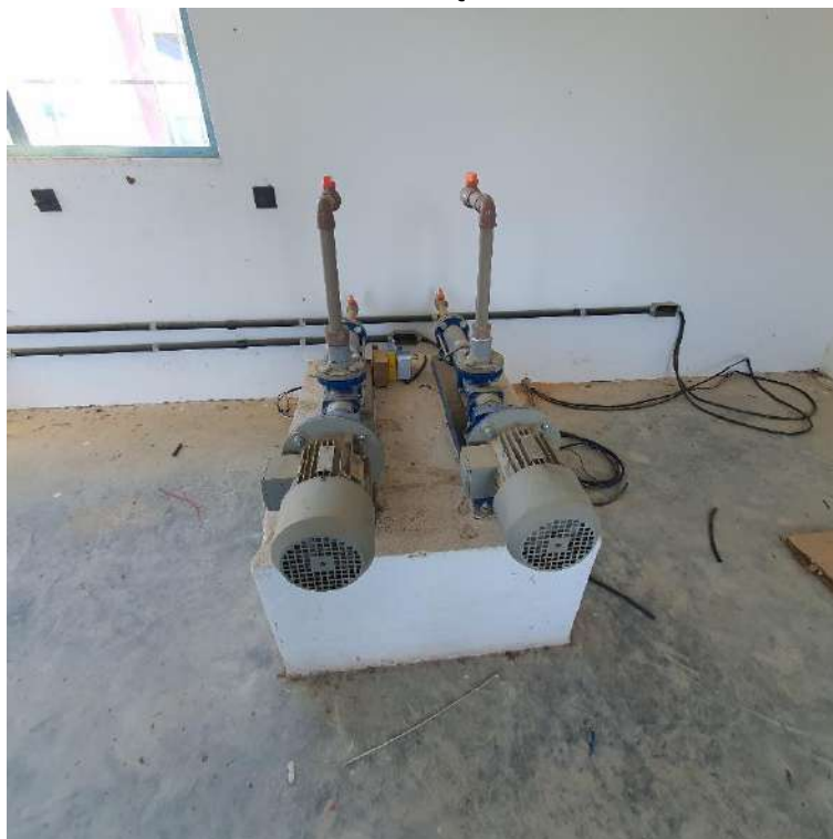
FIGURA 110 – DOSADORES DE QUÍMICOS – ETE CENTRAL
