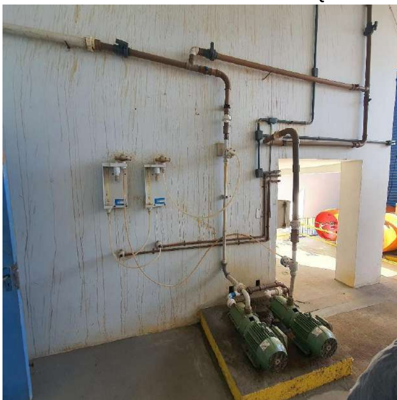
FIGURA 45 – BOMBAS DOSADORAS DE PRODUTOS QUÍMICOS
