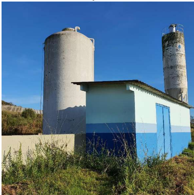
FIGURA 109 – RESERVATÓRIOS DE QUÍMICOS E DOSADORES – ETE CENTRAL
