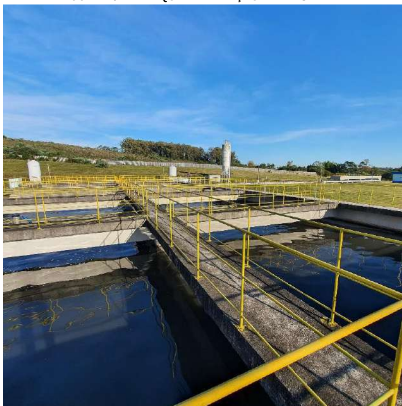
FIGURA 102 –TANQUE DE AERAÇÃO - ETE CENTRAL
