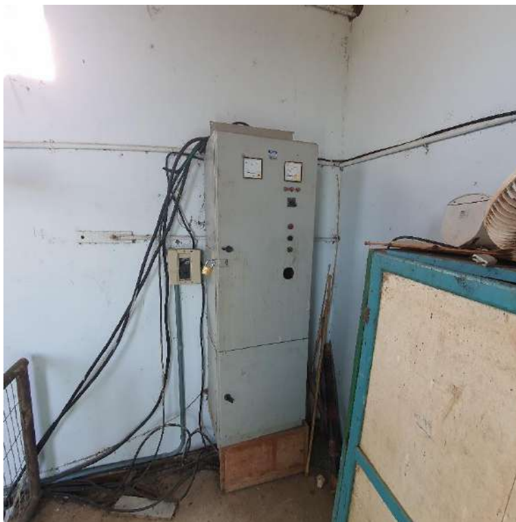
FIGURA 28 - PAINEL ELÉTRICO EEAB - BARRAGEM EMERGENCIAL
