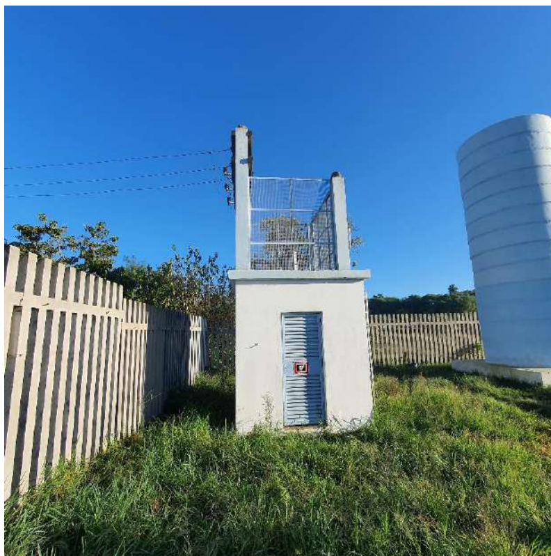
FIGURA 88 – ENTRADA DE ENERGIA ELÉTRICA DA EEEB DE BAGÉ
