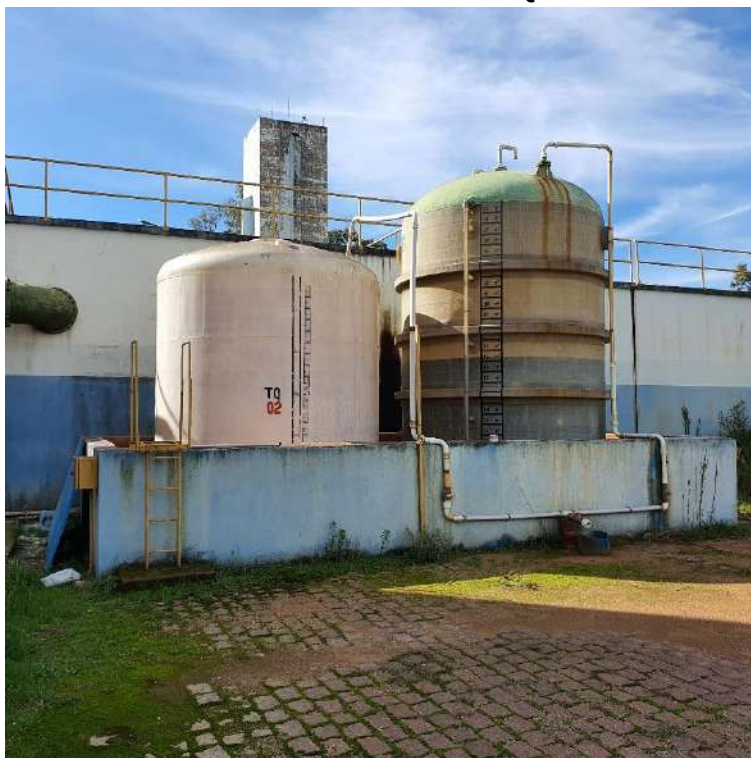
FIGURA 47 – RESERVATÓRIOS DE QUÍMICOS
